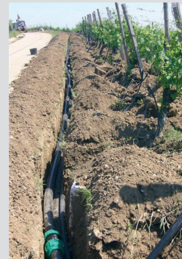
Einsatz POLYFAST AZ-Kupplung in einem Bewässerungsstrang
